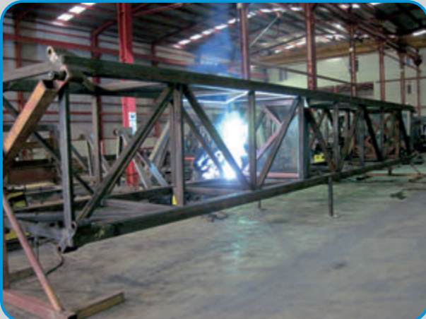
KAYNAK İSTASYONU WELDING STATION
