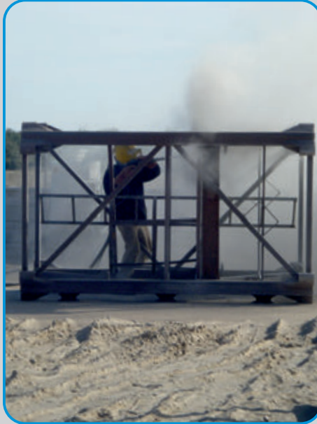
KUMLAMA İSTASYONU SAND BLASTING STATION
